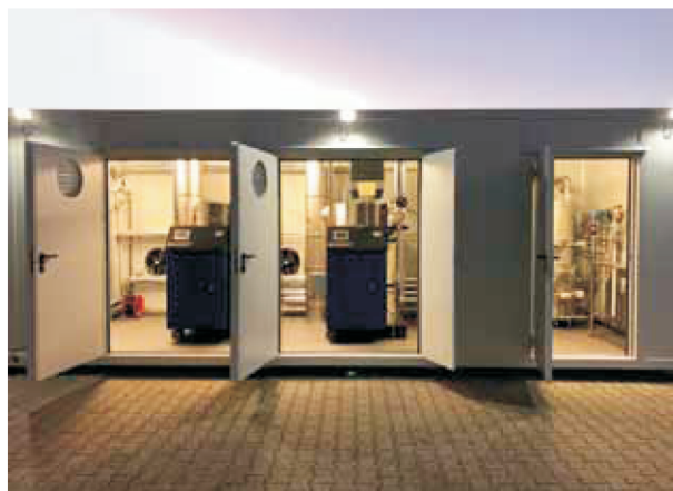
Ilustracja: kotłownia kontenerowa
